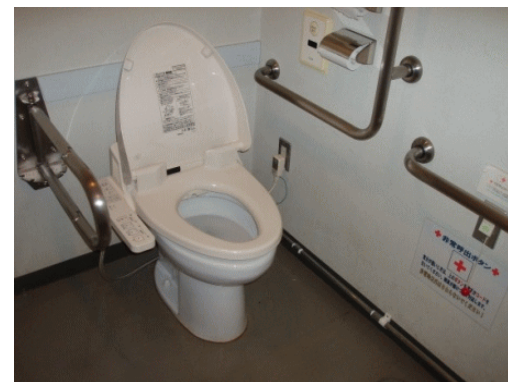
温水便座付き多目的トイレ(4箇所)
