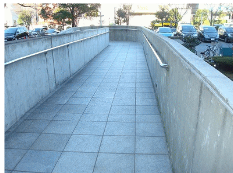
体育館棟入口へのスロープ 手すりも設置されています
